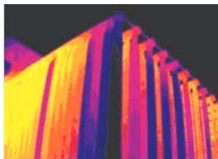
شکل ۲-۱۵- ترانسفورماتوری که لوله های و پره های رادیاتور آن دچار گرفتگی شده است.
