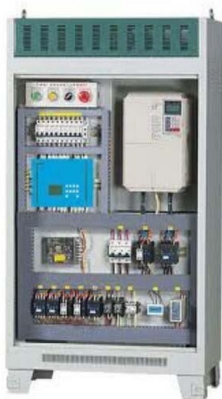
شکل (۴-۷). نمایی از داخل یک تابلو روشنایی
